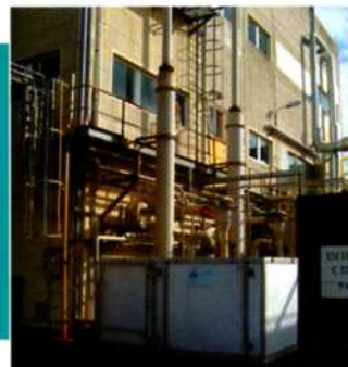
Unité modulaire pour traitement des COV par oxydation catalytique sur site industriel
