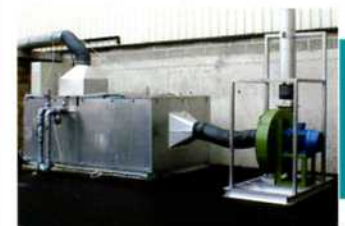
Unité Sorbicat : sur site industriel (cabine de peinture)
