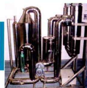
Unité pilote : 50 Nm 3 /h
