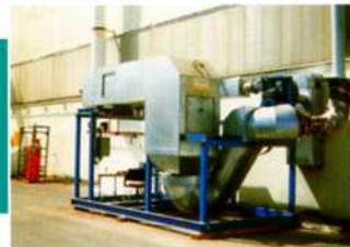
Pilote COV oxydation catalytique
